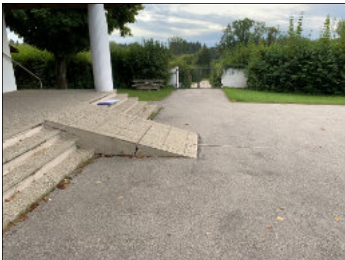
Vorher - marode Treppe und zu steile Rampe
